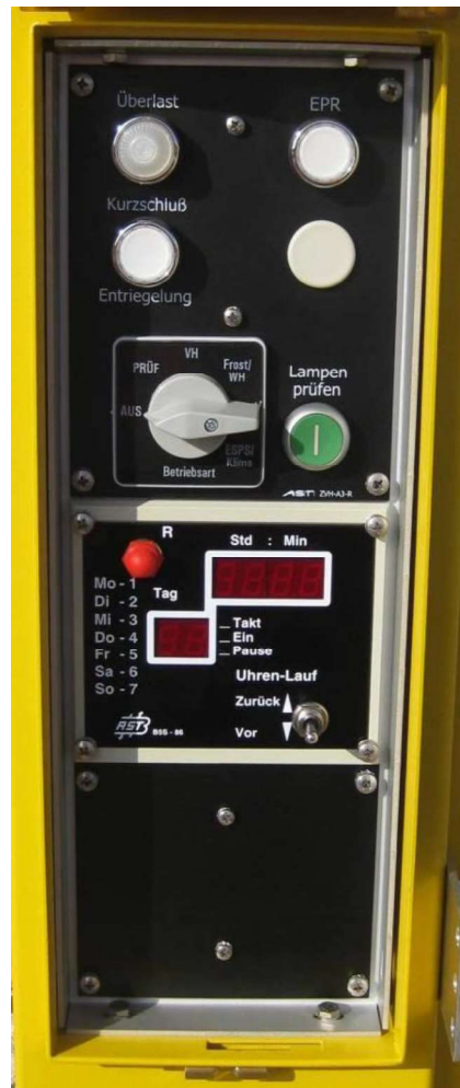
Heiz-Steuersäule – Bedienfeld (nur außerhalb der Halle !)
