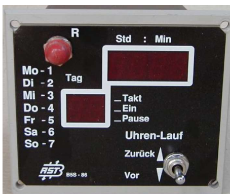
Schaltuhr (B5S 86 -220 - ATS - DCF) (nur außerhalb der Halle !)
