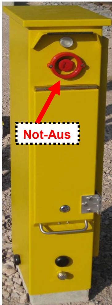
Heiz-Steuersäule – Außenbereich Verschlussklappe geschlossen
