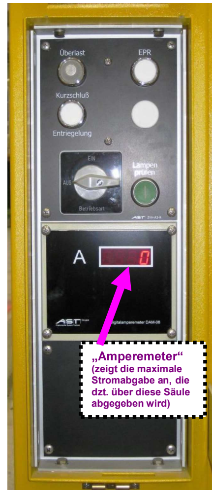
Heiz-Steuersäule – Bedienfeld (nur innerhalb der Halle !)
