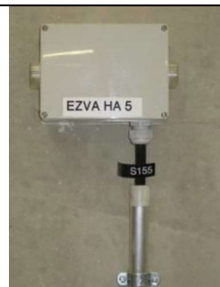
„Frontalansicht“ der 2 „Kopfleuchten-Melder“ für die EZVA Nr. 5
