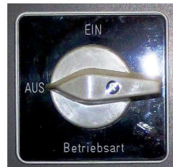
Betriebsartschalter (nur innerhalb der Halle !)
